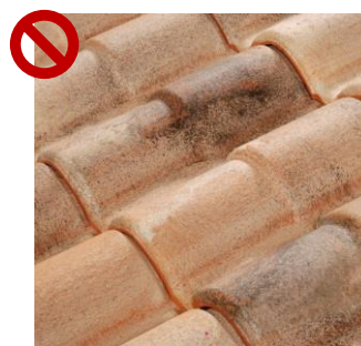
Figure 3 : Exemple de tuile au ton vieilli interdit
